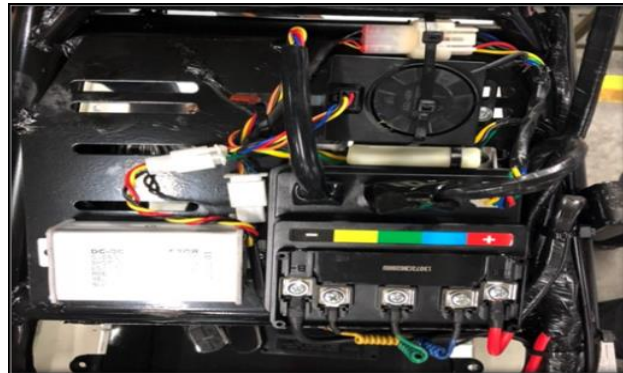
รูปที่ 4.3.4. แสดงผลการติดตั้งคอนโทรลเลอร์
